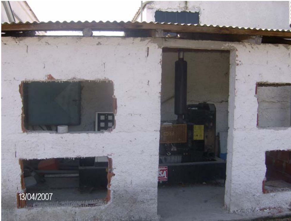
Φωτογραφία 2 :Γεννήτρια ηλεκτρικής ενέργειας
